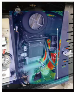
管路局部温度过高检测
