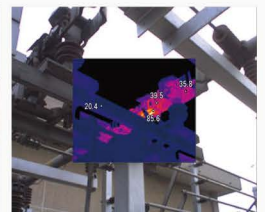
刀闸接触不良过热
