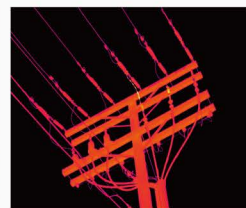
输电杆塔接头过热
