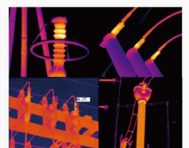
输电设施接头温度过高
